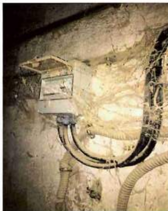
Riesgo eléctrico en fábrica de piensos. Fuente: PBE. Subinspectora Laboral. ITSS.
