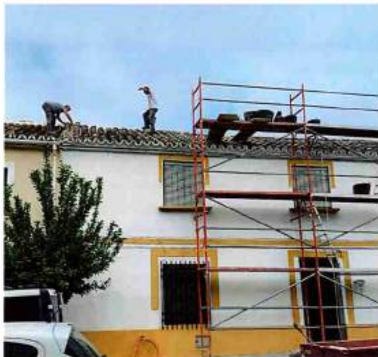
Riesgo en trabajos de construcción. Foto: Luis M. Silgo. Subinspector Laboral, ITSS.
