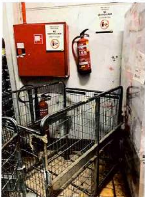
Riesgo medidas emergencia. Foto: Marta Padilla, Subinspectora Laboral, ITSS.
